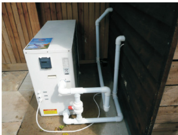
Separata ventiler för IN-kommande och UT-gående vatten saknas
