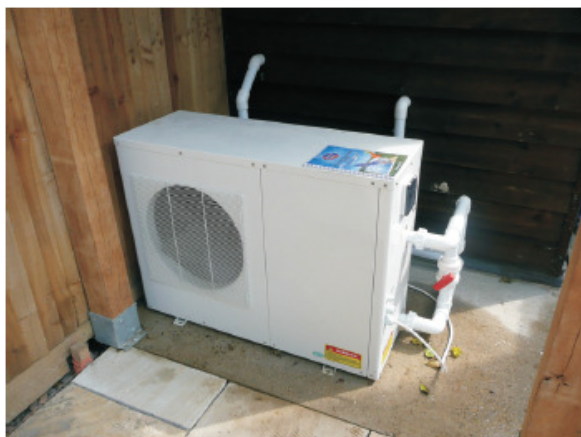
Aggregatet är placerat för nära väggen
